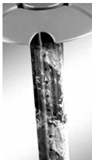
La presencia de termitas en la estaca
